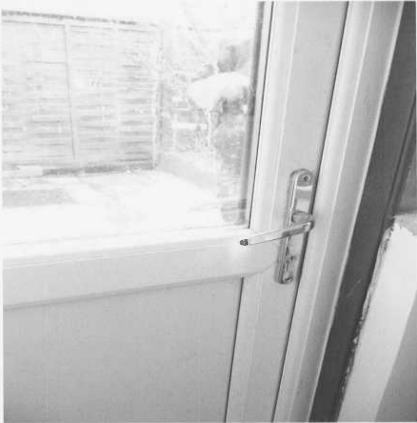
Back door lock
