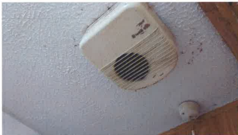
12) Bathroom : extractor fan
