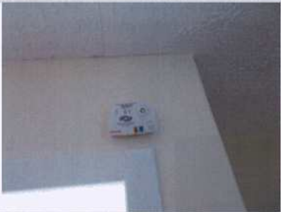
CO Alarm - UF landing
